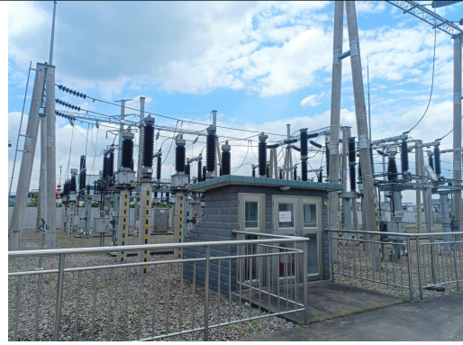
110kV 配电装置
